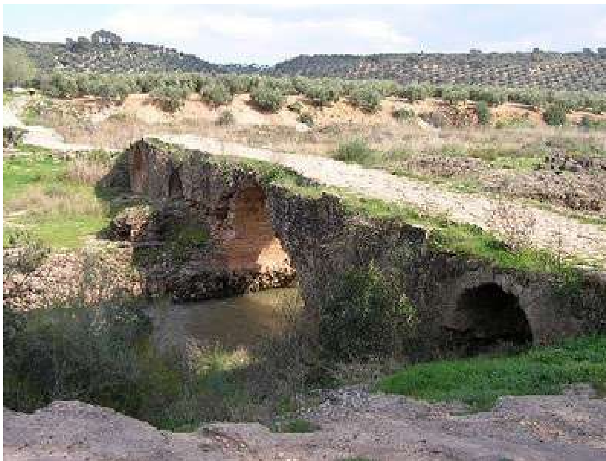
Arriba : Estado del puente Mocho antes de ser rehabilitado (2015-2016). Fotografía: Consejería de Medio Ambiente y Ordenación del Territorio
